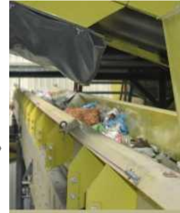
Die Grobbestandteile sind heizwertreich und werden in der MVA – Bremen entsorgt.
