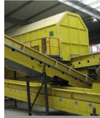
Trennung des Mülls in brennbare Fraktionen (Grobbestandteile) und in Feinbestandteile
